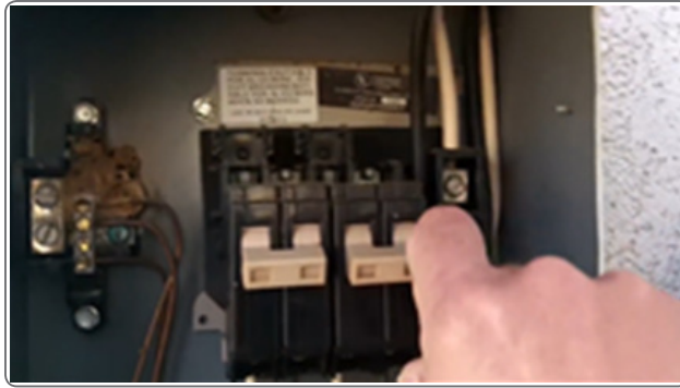
الشكل (٣): فصل التيار المتناوب عن طريق إنزال القواطع.
