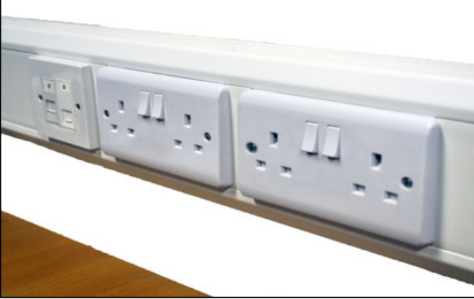
الشكل (٤٨): علب التوصيل الكهربائية
