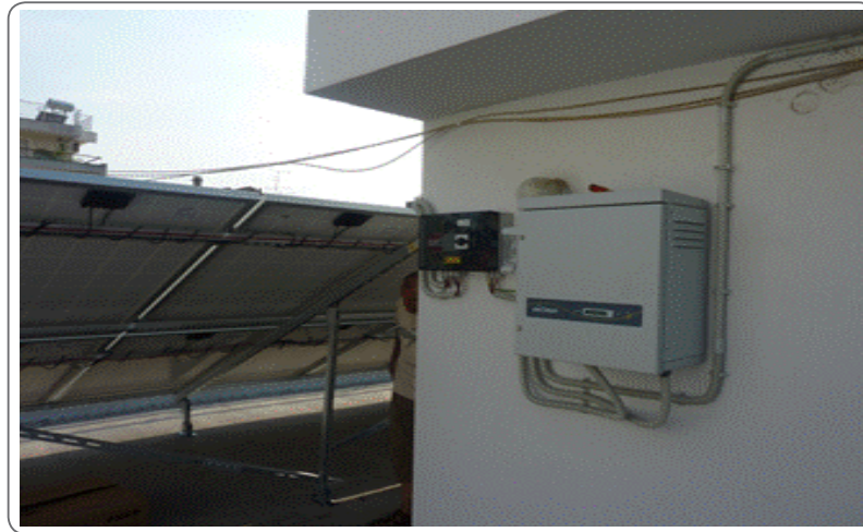
الشكل (٥): نظام شمسي كهروضوئي والكبلات الموجودة فيه بعد تركيبه.
