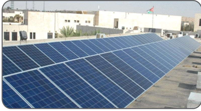
الشكل (١): نظام شمسي على سطح مبنى.
